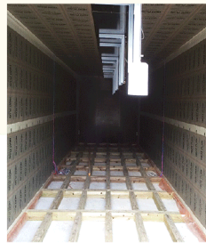
【壁/天井 暖房 材木乾燥室】
